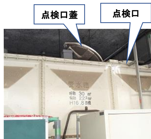
【点検口（受水槽上部）】
