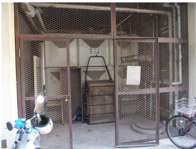
【受水槽室入口】
