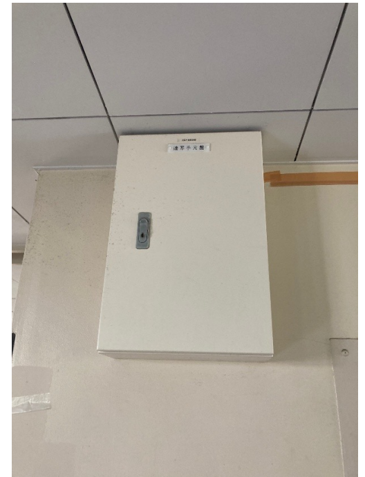
3階階段廊下の連結ボックス
